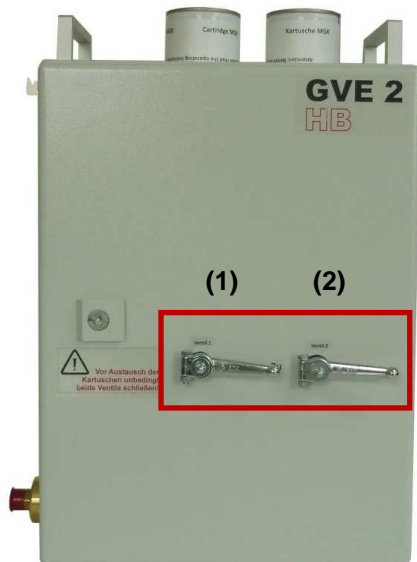
Abbildung 4: Schließen der Ventile
