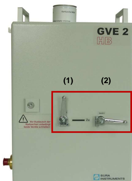
Figure 5 : Ouvrir la vanne de gauche
